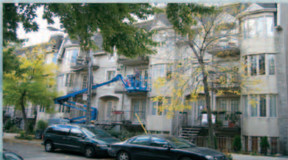
SYNDICAT DE LA COPROPRIÉTÉ 4478 LAVAL Restauration professionnelle et ponctuelle des joints de mortier défectueux
